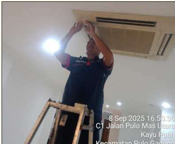
Gambar 3.17. Pengkondisian Tata Udara Kantor Pusat KKP
